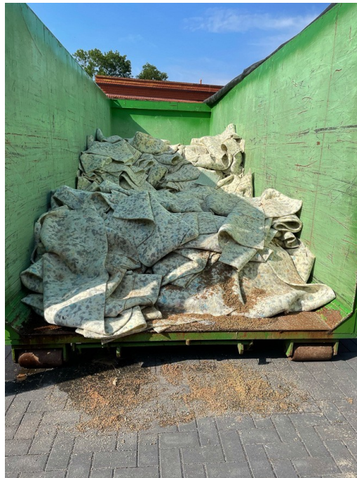
Klitschnasses Dämmmaterial aus der Schulturnhalle wird vollständig entsorgt.
