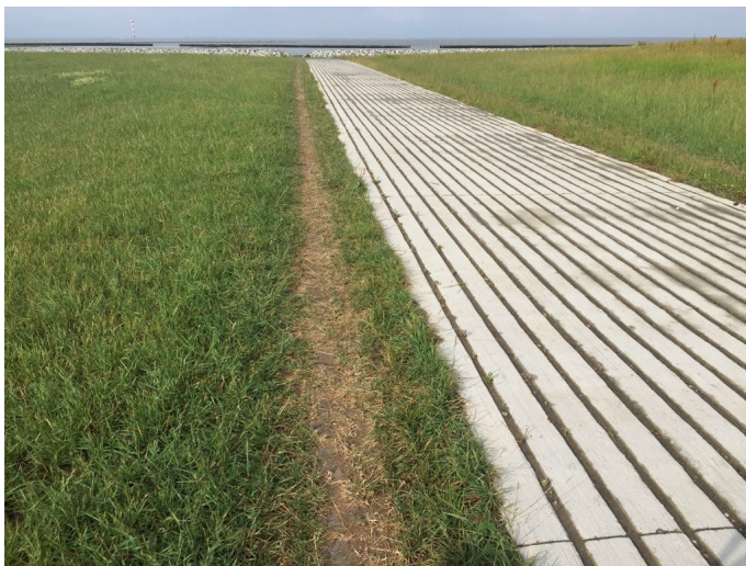
Vor Schottwarden verhindert der Beton mit tiefen Riffeln das Befahren durch Radfahrer.
